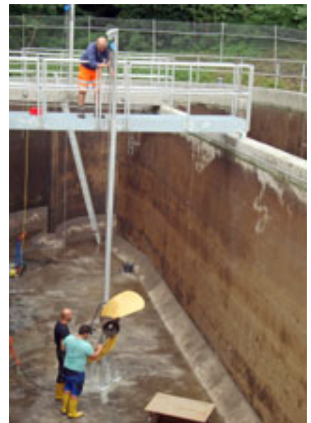
Verankerung der Rührwerke am Boden des ausgepumpten Belebungsbeckens
