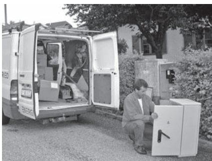
Einbau der Managementgeräte
