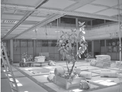
Installation der Veranstaltungstechnik in der Aula
