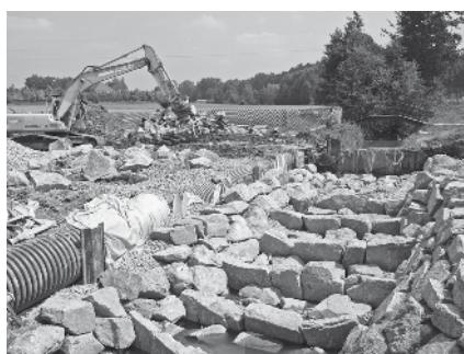
Die Errichtung des Fischaufstieges im Bereich des Zusammenflusses des Bründlbaches und des Raaber Baches
