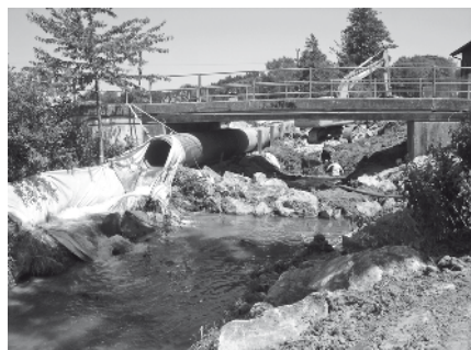
Zur Trockenlegung des Bachbettes musste das Wasser durch ein großes Rohr umgeleitet werden
