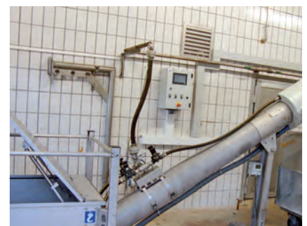
Rechen- und Sandwaschanlage in der Kläranlage
